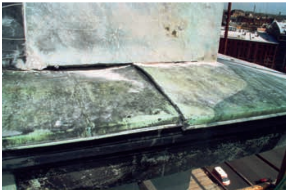
Нарушение окрытий. 2000-е
