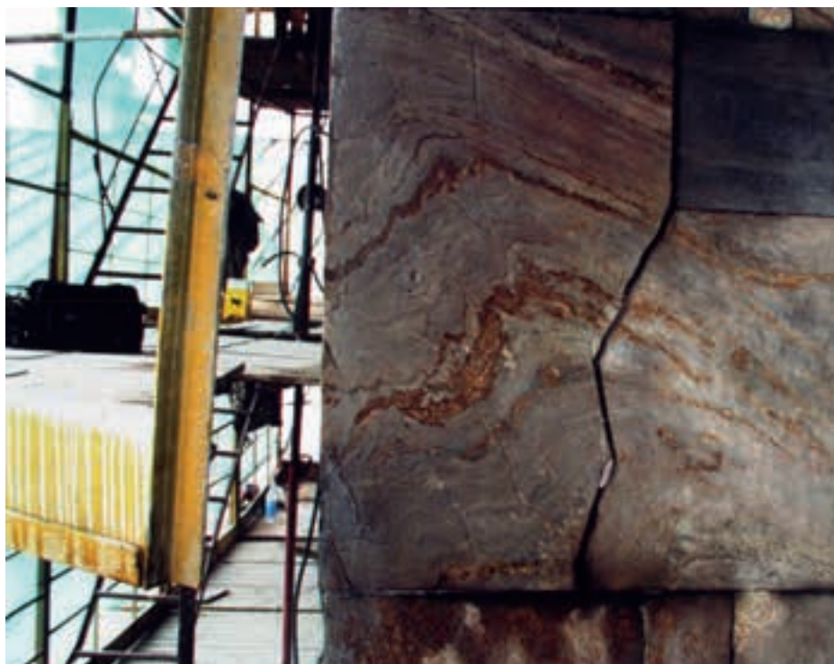
Трещины в мраморной облицовке. 2000-е
