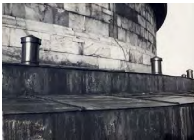
1955 год. Трубы вентиляция Исаакиевского собора. Фото © СПб ГБУК «Государственный музей-памятник «Исаакиевский собор», 2022
